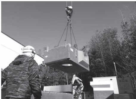
第7図 第二の地下ピットの底面部を輸送車両の荷台から吊り下ろす様子
