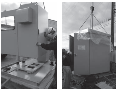
第13図 左：チャンネルベースにシステム制御盤を設置する様子 右：金属製キャビネットを上から吊り下ろす様子
